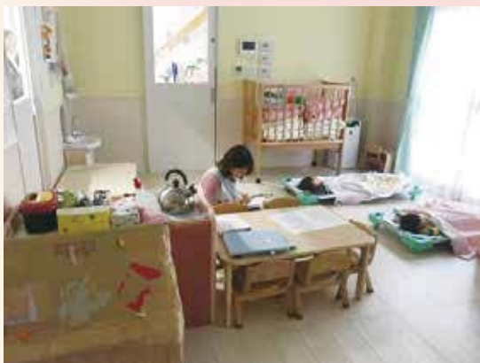
床暖房が設置された保育室内
