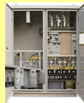
高圧受電設備
